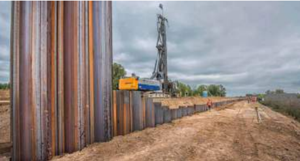
Damwand tegen piping (Opheusden).
