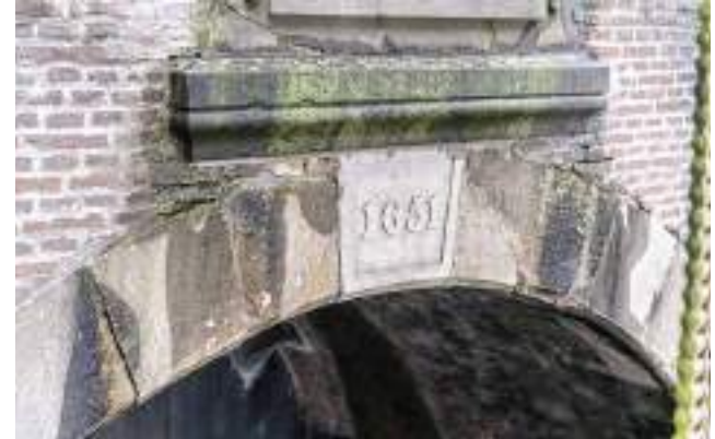
Bij het ontwerp van de dijk zorgt de gemeente voor aanvullend budget om monumentale elementen te behouden.
